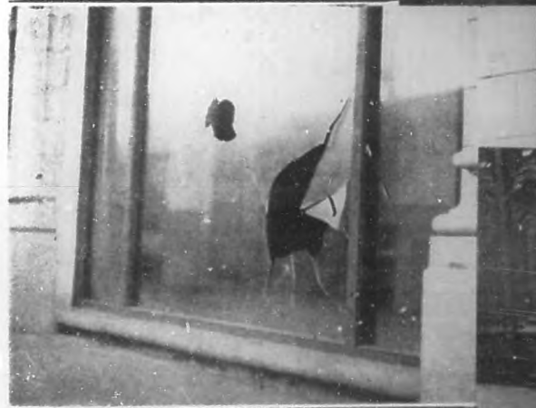
Una de las ventanas del Edificio Carrero, después de los choques entre policía y estudiantes.
